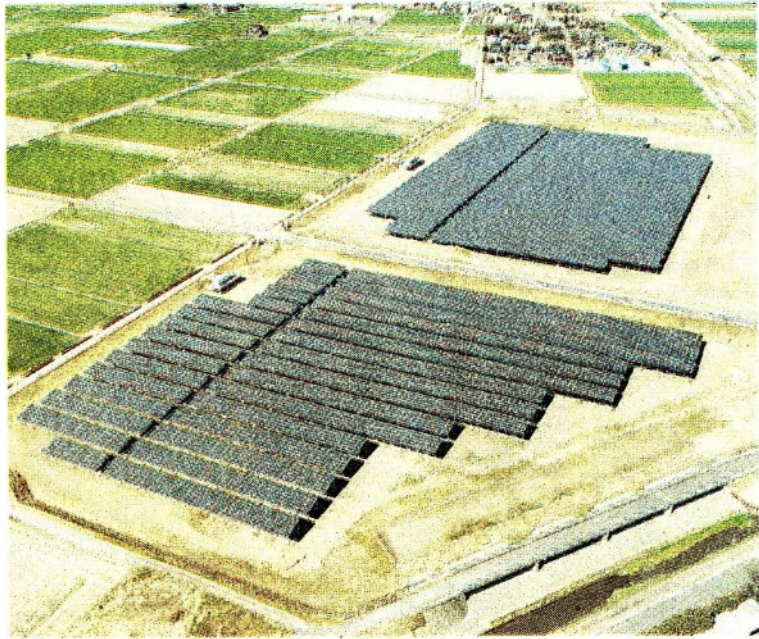
Energia pulita. Uno degli impianti di Infrastrutture Spa nell'area di Fukushima
